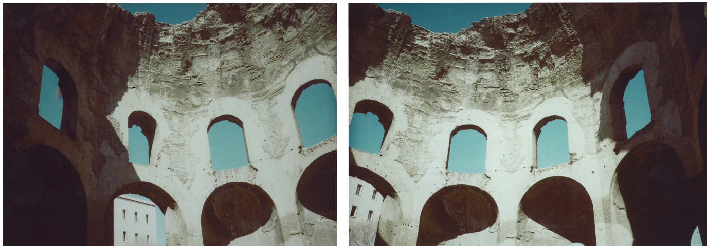
Figg. 3a, 3b. Prospetto interno Nord-Est: coppia stereoscopica per la restituzione fotogrammetrica (2002).
