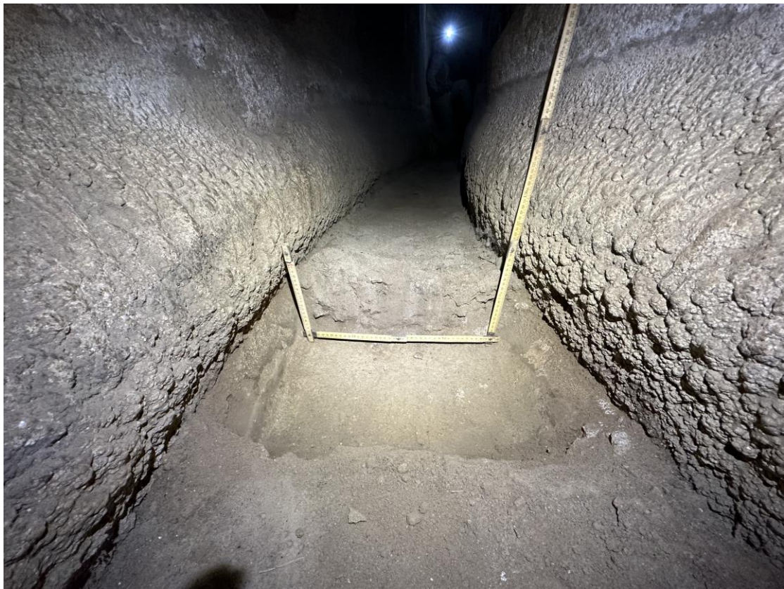
Fig. 9. Sezione idraulica del condotto in corrispondenza dello spiraglio R8, con deposito calcareo sui piedritti e pulvino alla base.
