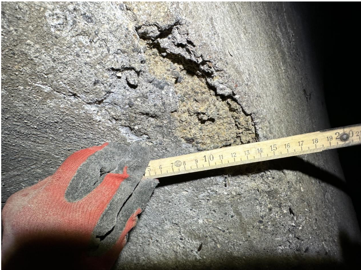
Fig. 10. Particolare dell'intonaco nella parte superiore del condotto, in corrispondenza di una svolta.
