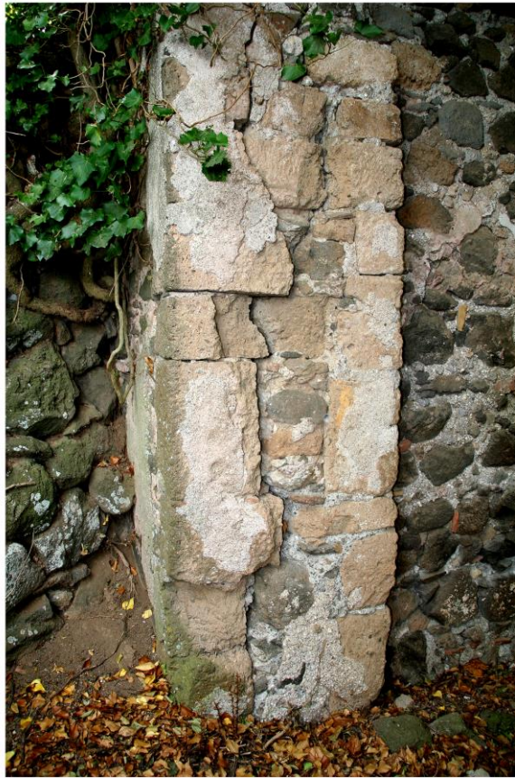
Fig. 14. Particolari delle murature del versante meridionale della Chiesa di San Bartolomeo in Sipicciano.
