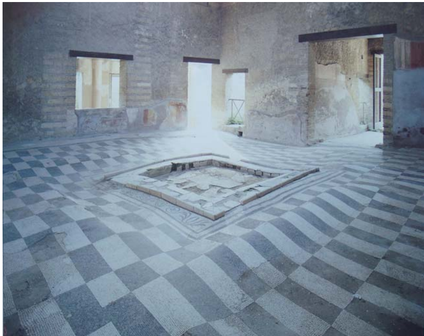
Fig. 8. L’atrio con la pavimentazione a mosaico avvallata dal peso dei materiali eruttivi.
