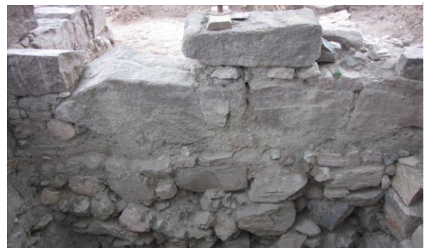
Fig. 7. Muro perimetrale USM 3041, la parte sommitale è costituita da grossi blocchi, pertinenti all'età romana imperiale, che poggiano direttamente sul muro arcaico in fondo.
